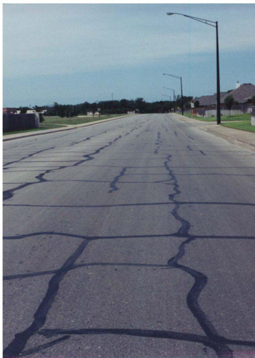
ภาพที่ 4 รูปแสดงรอยแตกสะท้อนบนชั้นผิวทางแอสฟัลต์คอนกรีตก่อสร้างบนชั้นพื้นทางซีทีบี ในประเทศสหรัฐอเมริกา [9]
